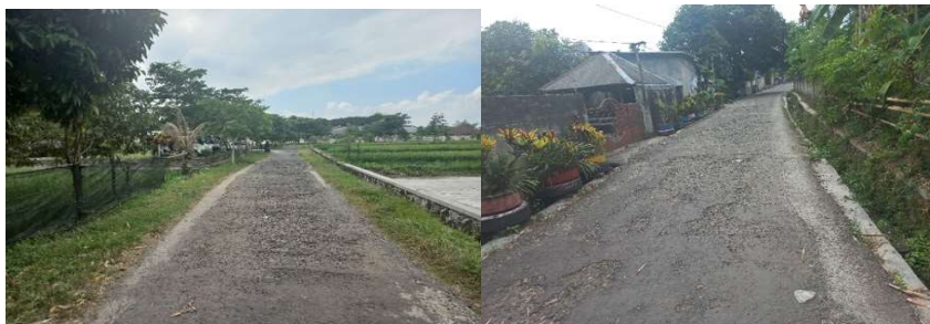
Gambar 5 . Kondisi jalan di dusun Karang Kates
