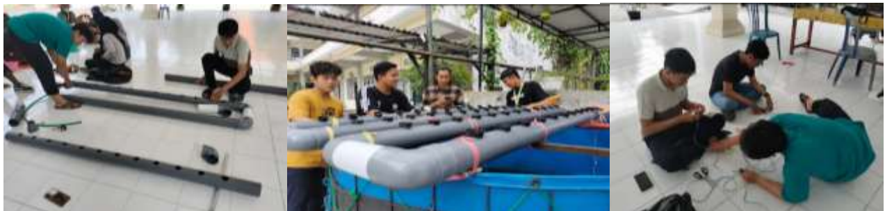
Gambar 4. Penyambungan pipa (a) Menghubungkan pipa dengan kolam ikan (b) Penyambungan listrik untuk pompa air (c)
