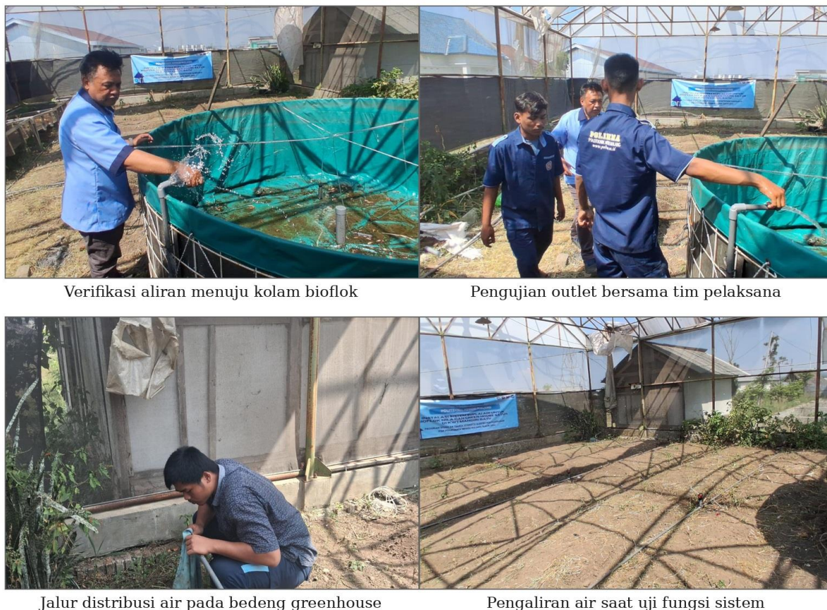
Gambar 3. Uji fungsi aliran dan kondisi jaringan distribusi pada lokasi mitra.
