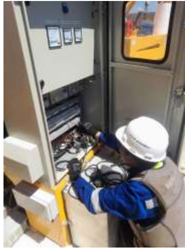
Gambar 3. Praktik pengukuran dan safety handling saat terjadi trip atau indikasi korsleting pada panel.
