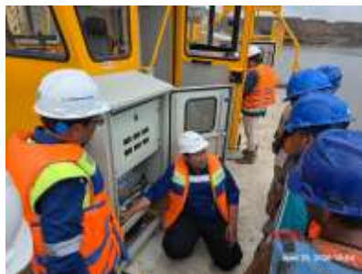
Gambar 1. Identifikasi part yang berpotensi konslet apabila terkena air pada area panel Dredger.
