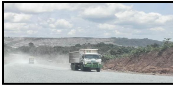
Gambar 7. Kerusakan Permukaan Jalan Angkut.
