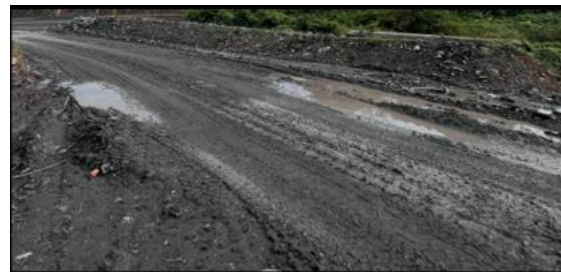
Gambar 8. Kondisi Permukaan Jalan Berdebu ( Dusty Surface ) Pada Jalan Angkut.
