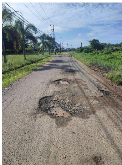
Gambar 2. Kondisi Ruas Jalan.
