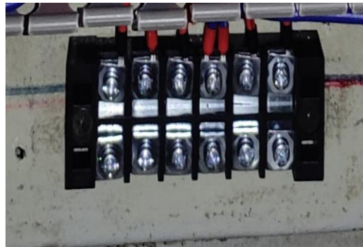
Gambar 9. Instalasi Terminal blok 2x6
