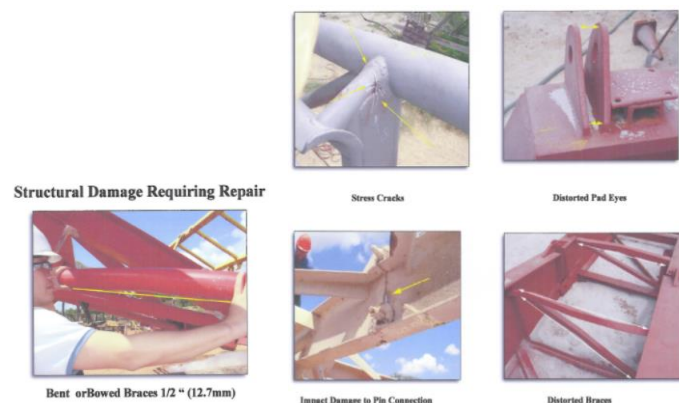
Gambar 7. Contoh Kerusakan Mekanis Dan Perbaikan Pada Komponen Inspeksi dan NDE
