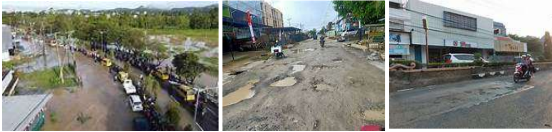
Gambar 3 Ruas Jalan di Distrik Timur yang tidak memiliki sistem drainase baik
