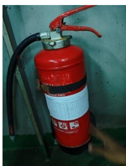
Gambar 2. Kondisi Fisik APAR
