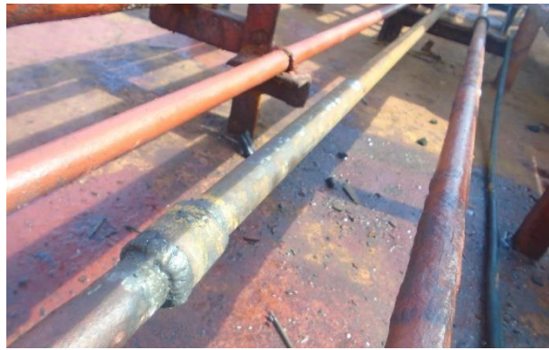
Gambar 5. Pembaruan Pipa Hydraulic
