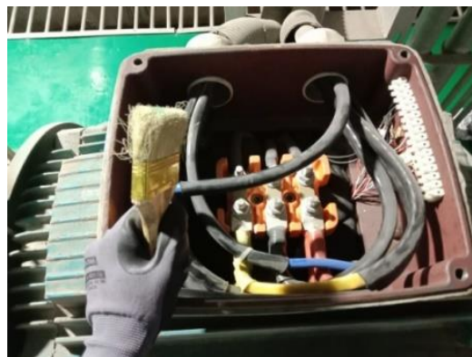
Gambar 9. Perawatan Motor Listrik
