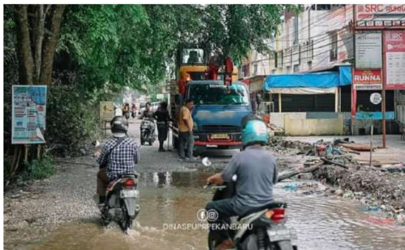
Gambar 1. Kondisi Jalan Umban Sari, Kota Pekanbaru
