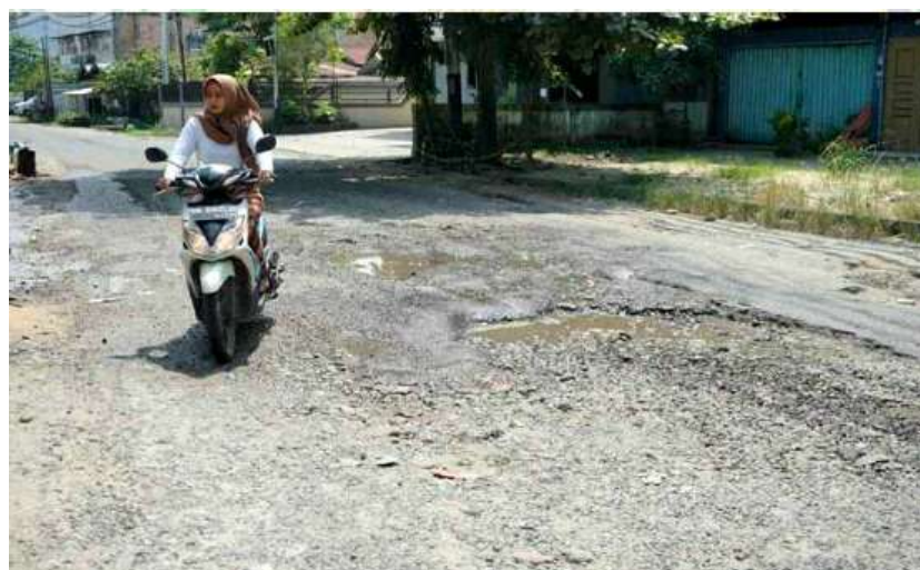
Gambar 2. Kondisi Jalan Tanjung Datuk, Kota Pekanbaru
