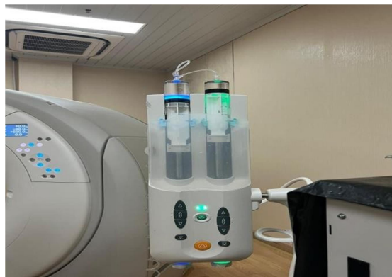
Gambar 4. Injektor di Rumah Sakit Bhayangkara Makassar
